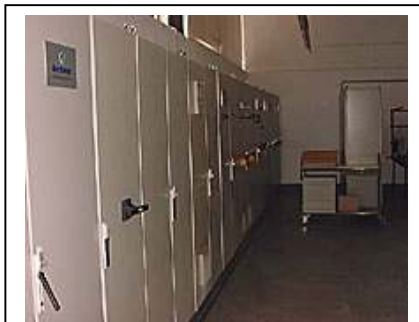
Prozesssteuerung Sandaufbereitung Kalksandstein Produktion
