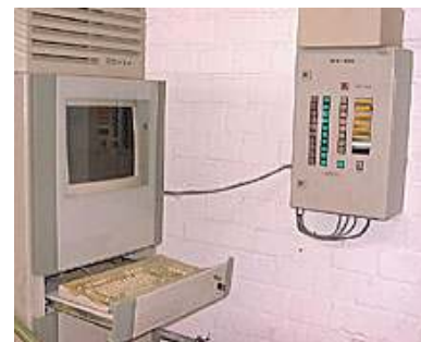
Rechner gesteuerte Visualisierung und SPS- Steuerung für Autoklaven
